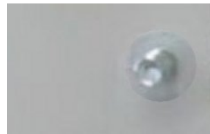
Abb. 26: Nicht gekennzeichnete Erdungsbolzen
