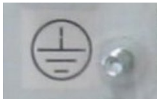
Abb. 25: Erdungsbolzen gekennzeichnet mit PE-Symbol
